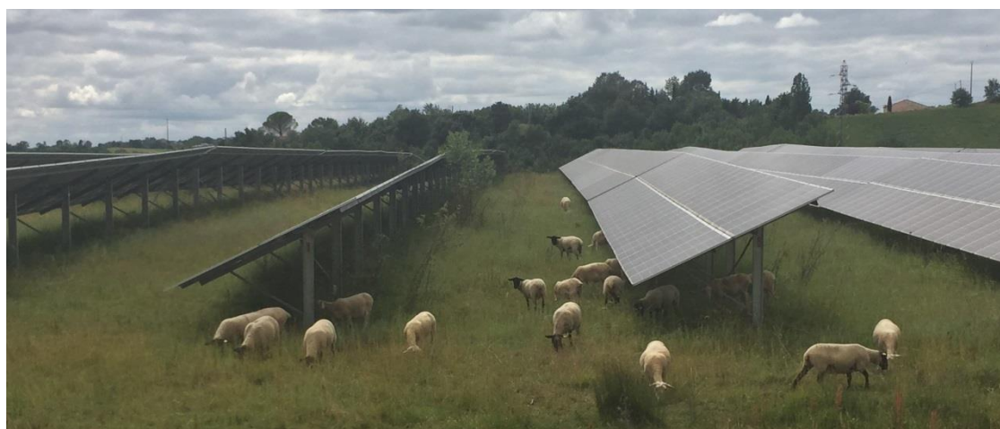
Exemple de cohabitation entre moutons et centrale photovoltaïque
