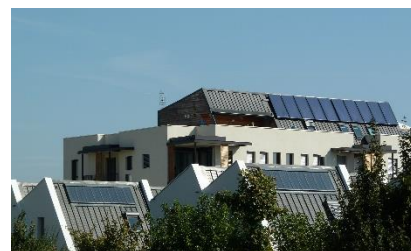
Chauffe-eau solaire sur des maisons (premier plan) et un immeuble de logement.
