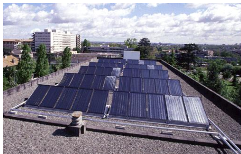
Capteurs solaires destinés à la production d'eau chaude sanitaire pour un hôtel.
