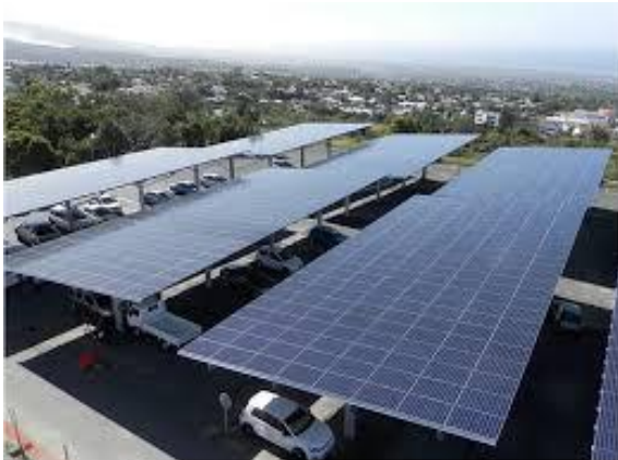
Ombrière sur parking
