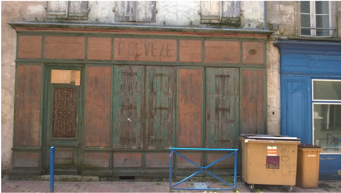
Figure 79 : Commerces fermés rue Saint Simon à Blaye (Photo Groupement RCT)
